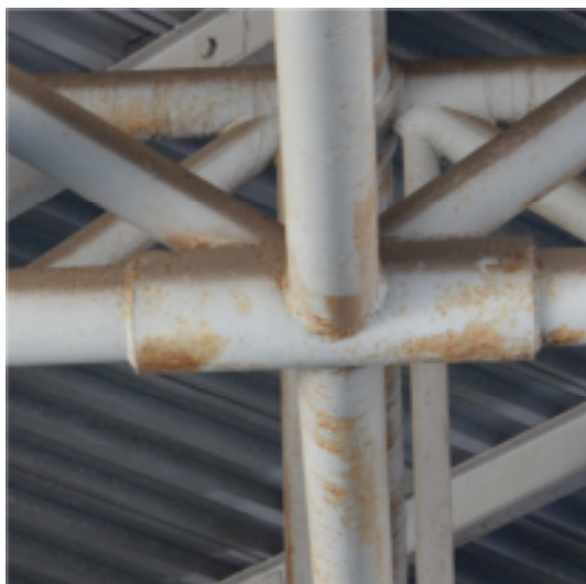
Obr. 2 Horní část konstrukce pokrytá vrstvou úsad
