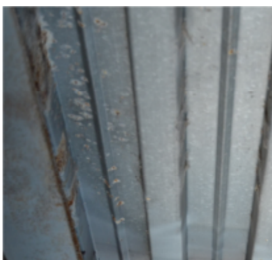
Obr. 19 Korozní produkty zinku, tzv. "bílá rez"(detail)
