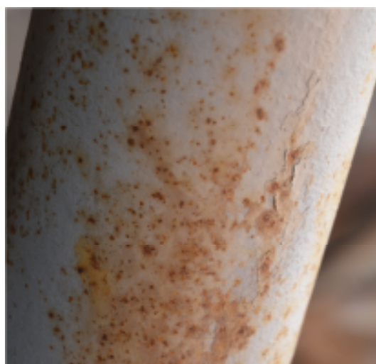
Obr. 11 Prorezavění a odlupování nátěru (detail)
