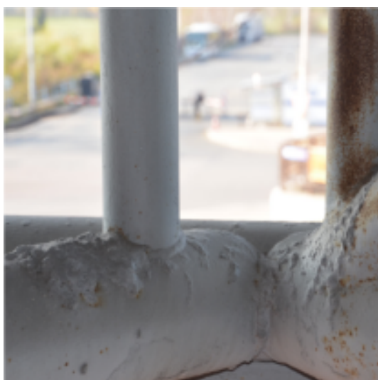
Obr. 4 Zbytky nikdy neodstraněného betonu
