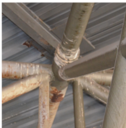
Obr. 5 Poteklá místa na konstrukci
