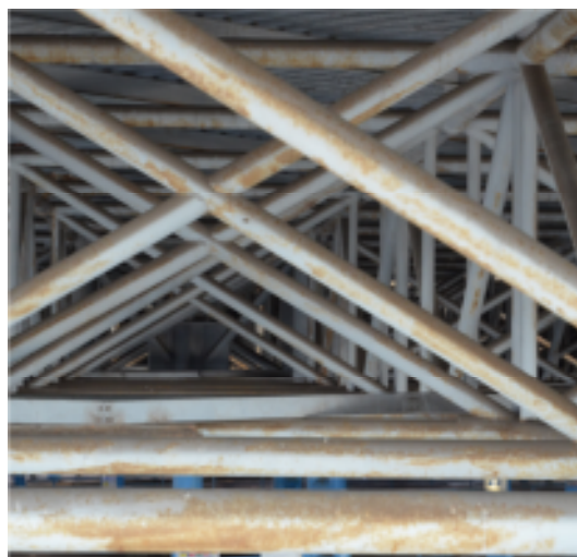
Obr. 9 Prorezavění nátěru (celkový pohled)
