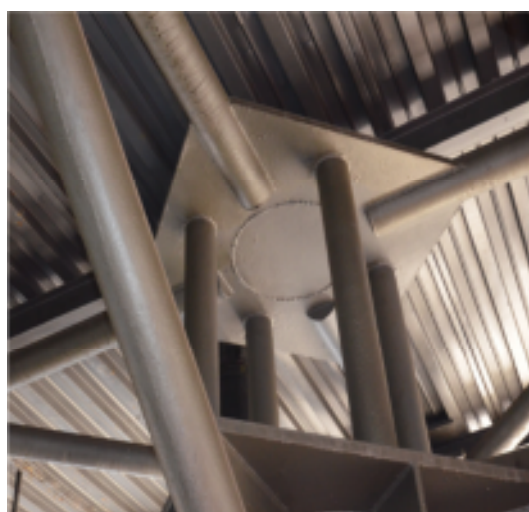
Obr. 13 Opravný nátěr tmavo-šedý (oprava 2006)
