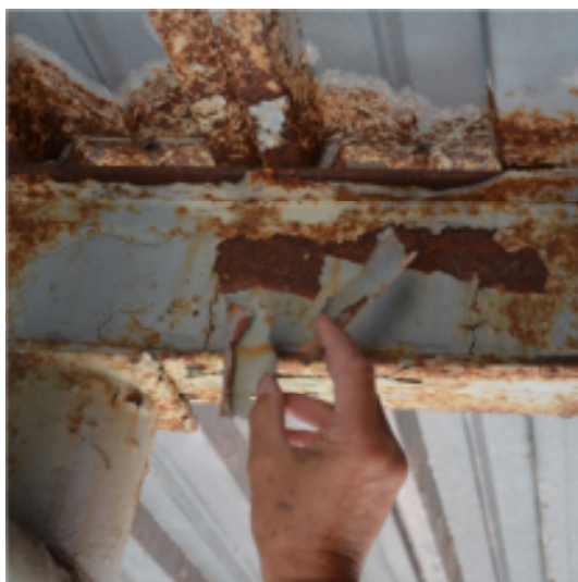
Obr. 17 Totální degradace nátěru / koroze zákl. materiálu
