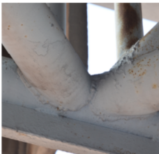
Obr. 12 Odlupování vrchní vrstvy nátěru (ztráta adheze)
