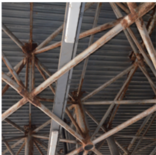
Obr. 14 Totální degradace nátěru v místech průsaků
