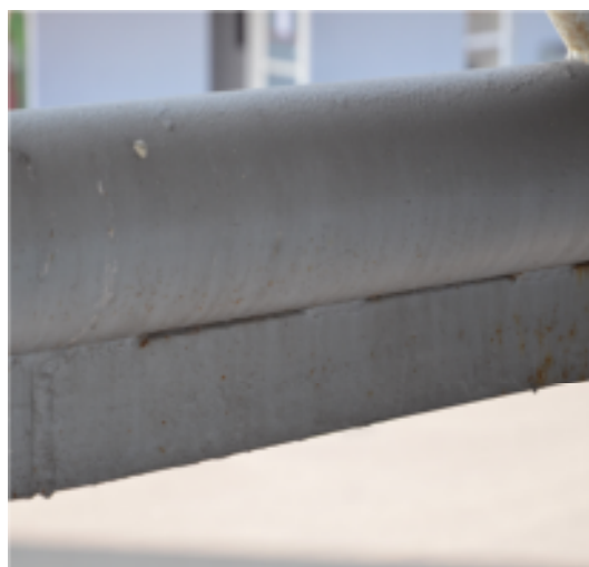
Obr. 7 Neutěsněné spáry (přerušovaný svar)
