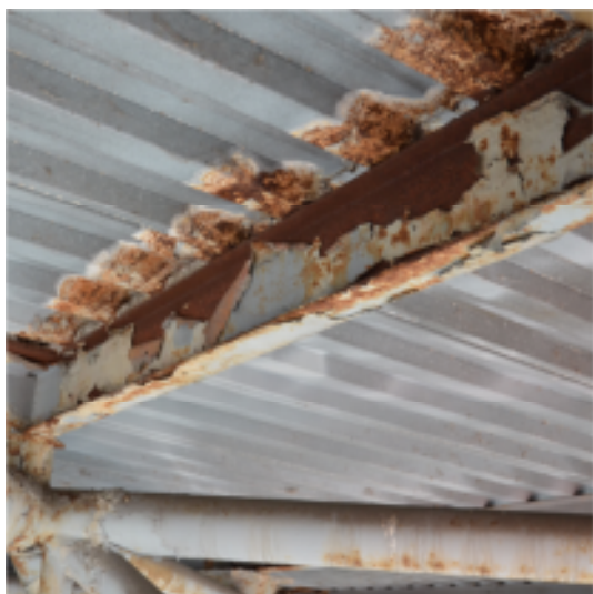
Obr. 16 Totální degradace nátěru / koroze zákl. materiálu
