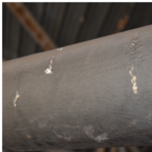
Obr. 3 Konstrukce pokrytá ptačím trusem
