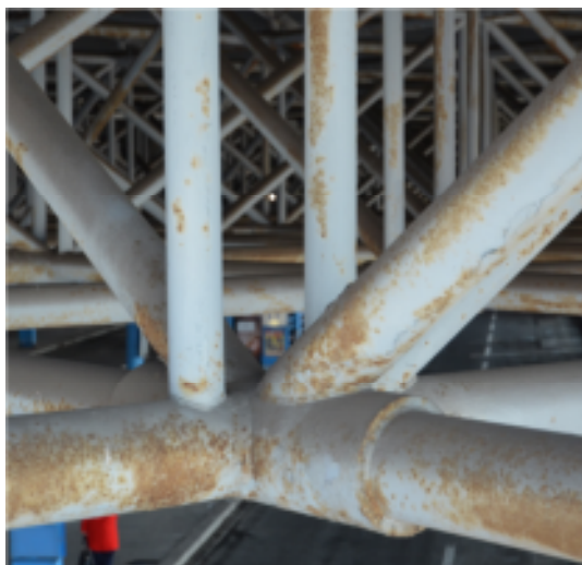
Obr. 8 Prorezavění nátěru (celkový pohled)
